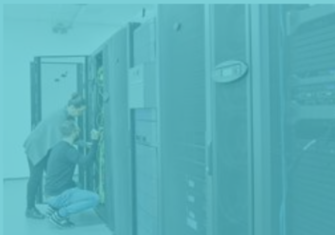
Due tecnici al lavoro nel data center dell'Università
